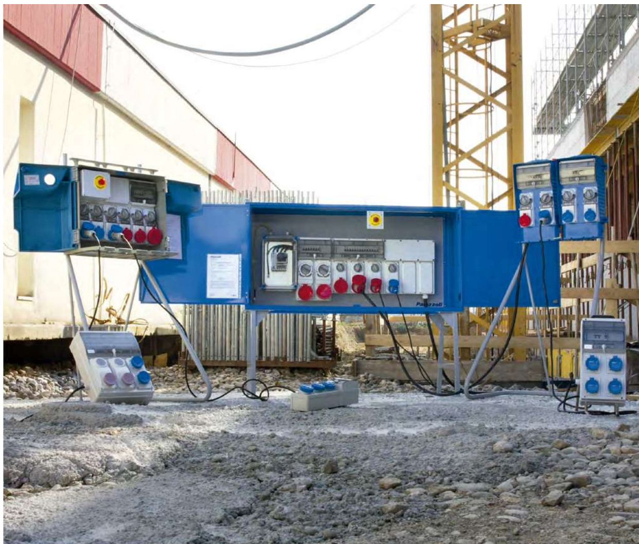
Quadros ASC De Distribuição e Transformação
